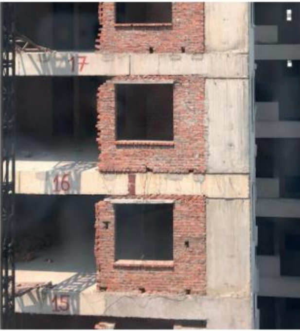
Fig.74 Assemblage de briques hasardeux sur le chantier du «Golden Millenium» / Photographie de l'auteur
