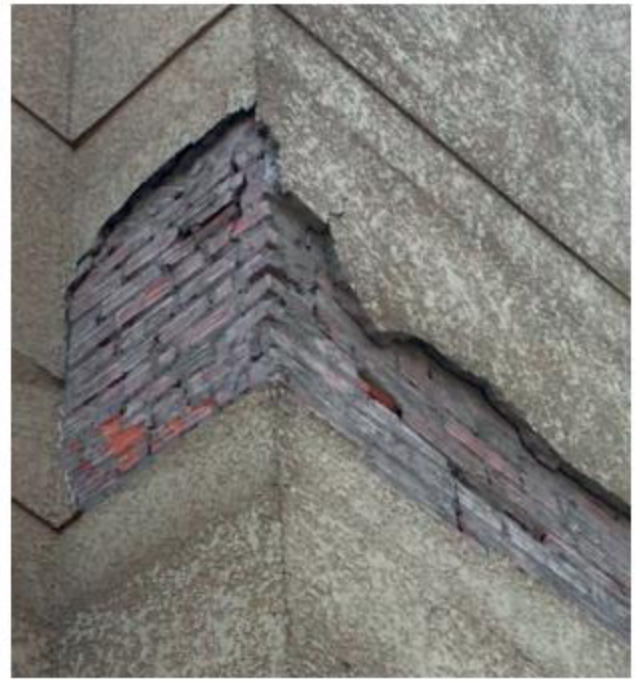
Fig.73 Façade décrépie de l'immeuble «The Manor» dix ans après sa réalisation / Photographie de l'auteur
